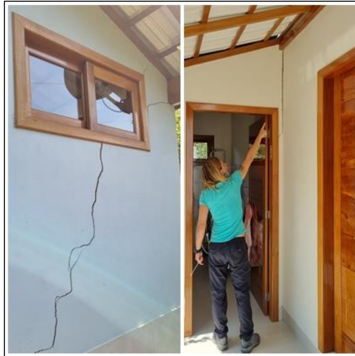
Figura 13 – Danos em residência
