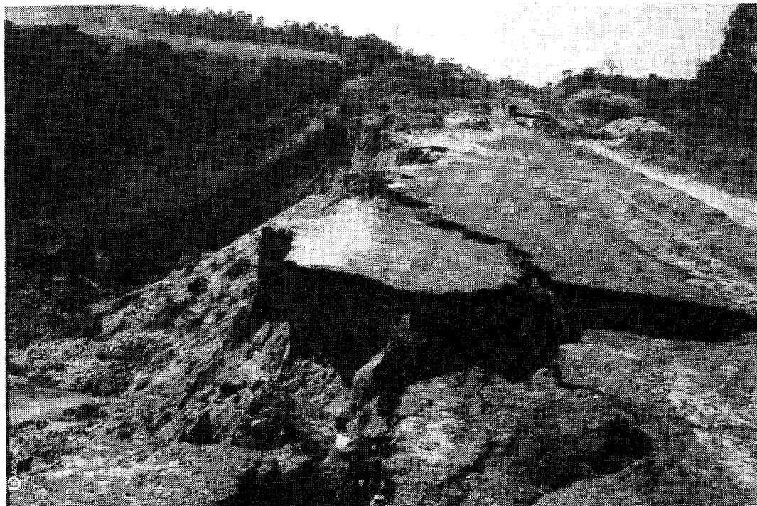
Figura 12 - Estrada totalmente destruída devido ao rompimento do aterro.
