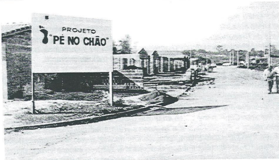
FOTO 1 - Primeiras construções do Projeto Pé-no-Chão, na área aterrada pertencente ao Leito Maior do Ribeirão Claro, onde se localizava uma lagoa, anteriormente ao aterro. A placa demonstra a responsabilidade da Prefeitura Municipal, com participações diretas das: Secretaria Municipal de Obras; Secretaria Municipal de Desenvolvimento, Planejamento e Meio Ambiente; e, Secretaria Municipal da Ação Social. Posteriormente foi criada e administra as obras a Secretaria Municipal de Habitação.
