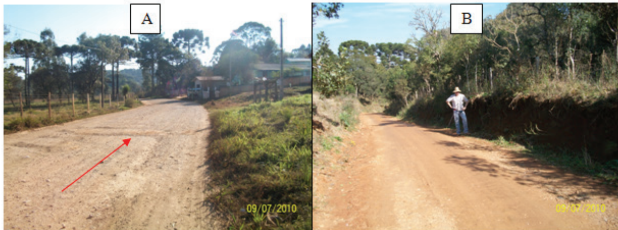
Figura 2. Estradas não pavimentadas.
