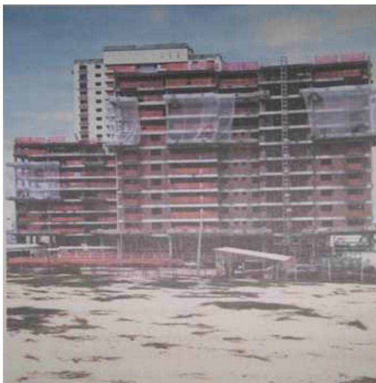
Figura 3: Construção de edifício em área de proteção ambiental em Natal – RN. Fonte: Martins et al. (2016).
