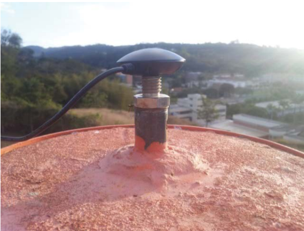
Fig. 3 - GPS G-STAR instalado no marco MET do IBGE.
