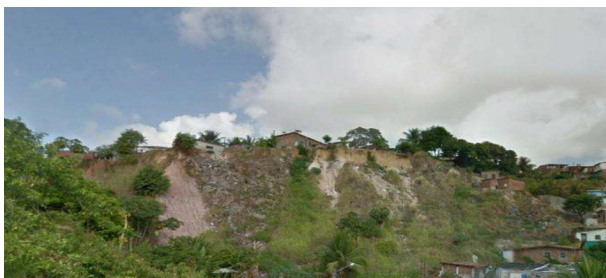
Fig. 3 - Setor de risco R4: Aglomerados subnormais em encosta de alta declividade desprovida de cobertura vegetal sobre processo erosivo.
