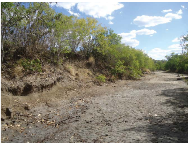
Fig. 9 - Canal de drenagem com maior profundidade, de regime fluvial efêmero e textura argilosa.
