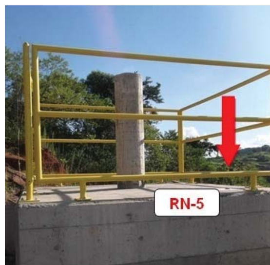
Fig. 2 - PG01 com a chapa metálica (RN-5).
