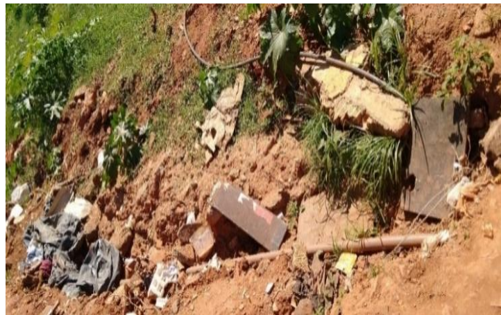
Figura 3 – Tubería enterrada tras un “gato” en la red del DMAE, rodeada de basura
