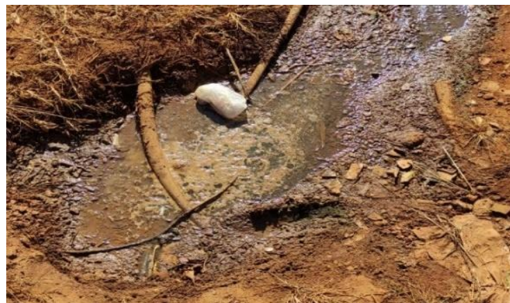
Figura 4 – Tubería en contacto con aguas oscuras
