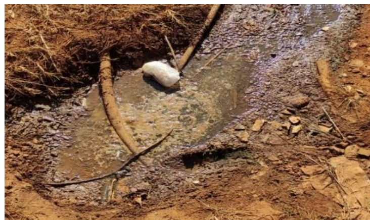
Figura 4 – Tubulação em contato com águas escuras
