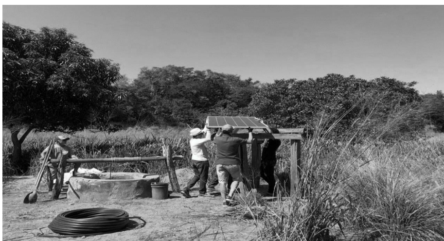
Imagem 1 – Instalação de placa solar no poço artesiano na comunidade rural Laranjeira
