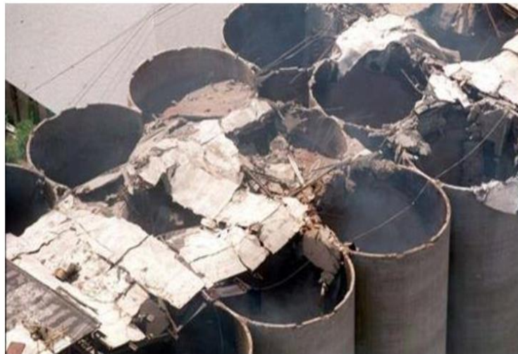
Figura 1 – Resíduos de explosão de uma bateria de silos.
