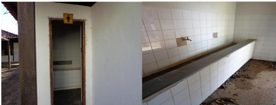
Fotografia 3 - Banheiro do Parque do Mocambo, com destaque para a falta de manutenção e limpeza
