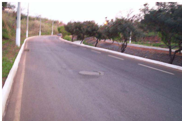
Figura 02: Interceptores no centro da Via e captação de água fluvial no lado esquerdo da Via.
