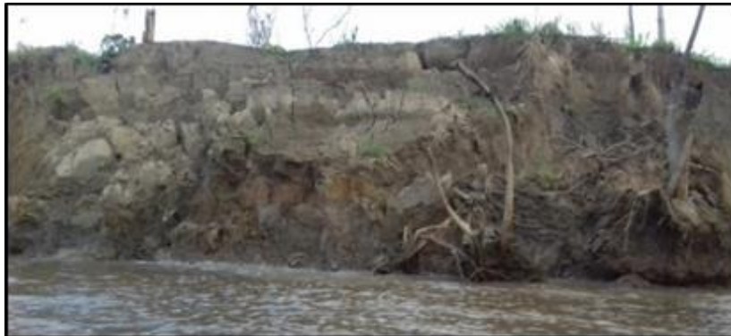
FIGURA 1 – Erosão Fluvial na comunidade Nossa Senhora da Paz.
