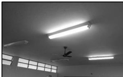
Figura 2. O ventilador localizado no centro da sala e as lâmpadas queimadas.
