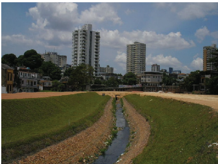
Figura 06: Trecho do igarapé de Manaus (Centro) canalizado e com margens aterradas/compactadas entre a Avenida 7 de Setembro e igarapé Bittencourt. Fonte: Waldemir Costa Júnior, 2007.
