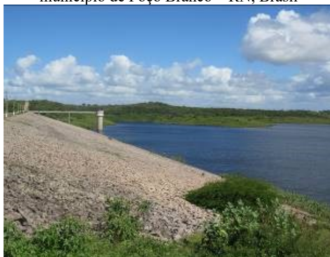
Figura 1: Barragem Engenheiro José Batista do Rego Pereira (Açude Poço Branco) no município de Poço Branco – RN, Brasil
