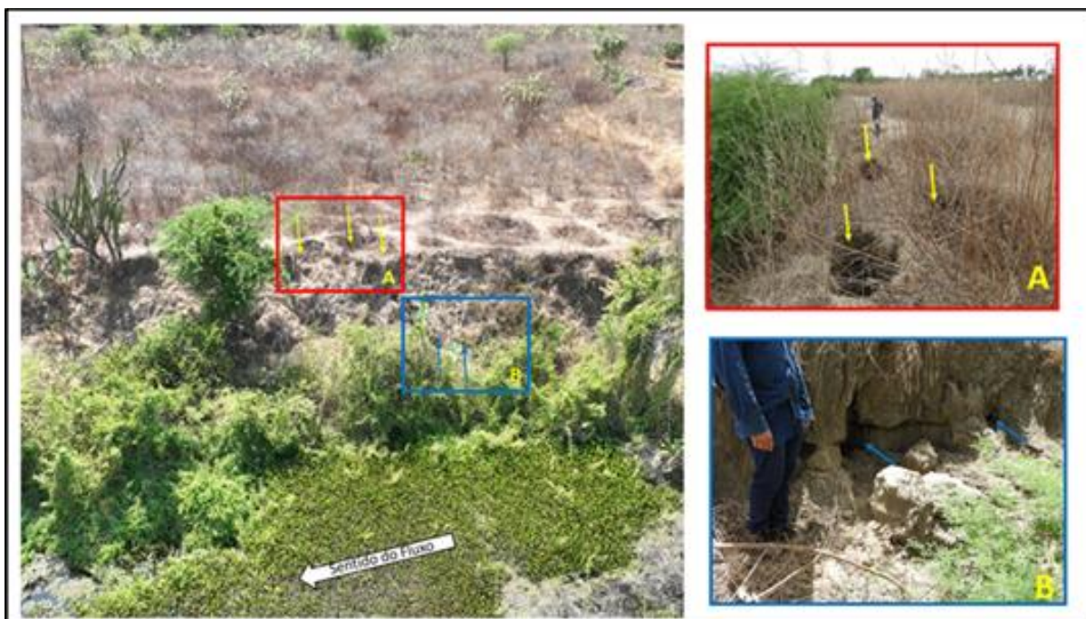
Figura 10 - Processo de erosão subsuperficial na seção Canela I, margem direita do rio Jaguaribe. Em A são apresentadas as depressões formadas pelos degraus de abatimento (setas amarelas). Em B são mostradas as saídas dos dutos na base da margem (setas azuis)
