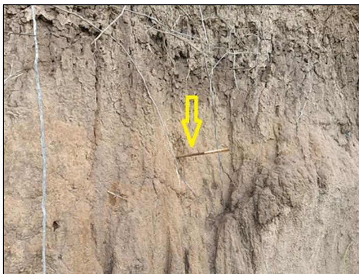
Figura 6 - Pino exposto pelo escoamento dos fluxos superficiais na seção Sucurujuba II, representado pela seta amarela
