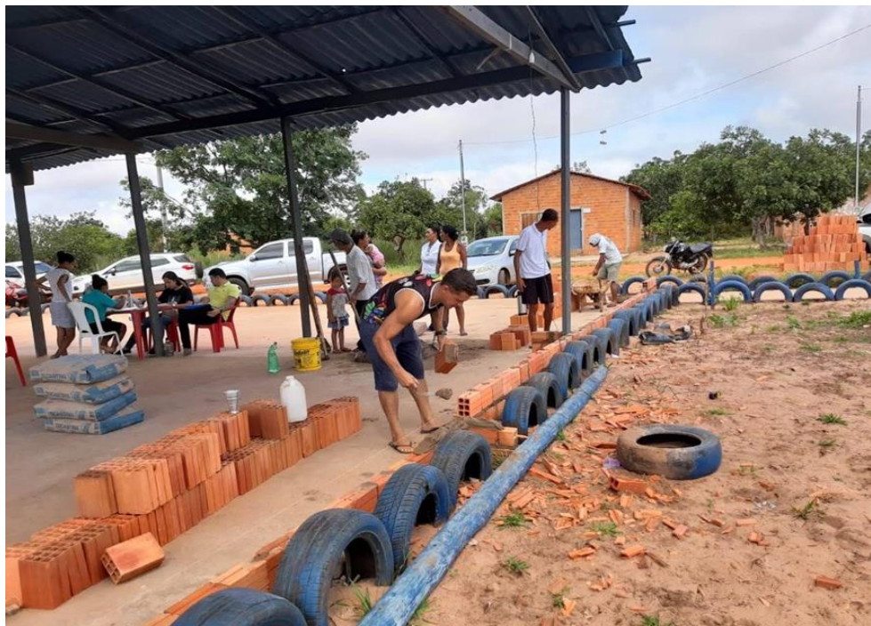
Figura 3 - Araguaína (TO): Mutirão da construção do galpão da Praça Maria Ferreira da Silva, 2019.
