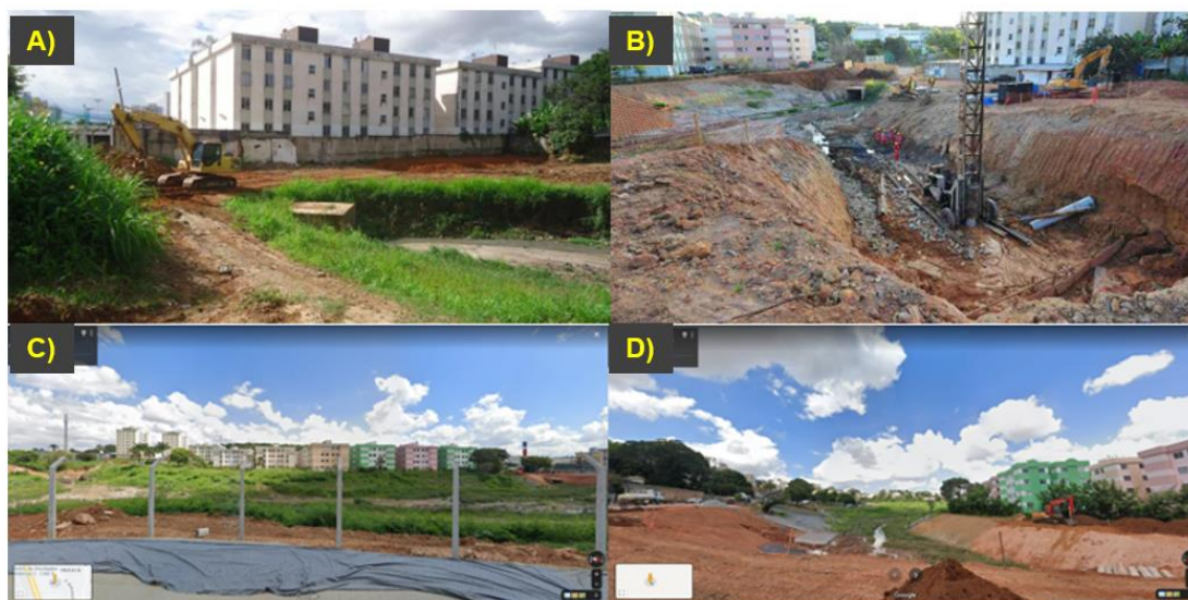
Figura 3 - Belo Horizonte (MG): Situações das obras da bacia em 2018 (A, B) e em 2019 (C e D).
