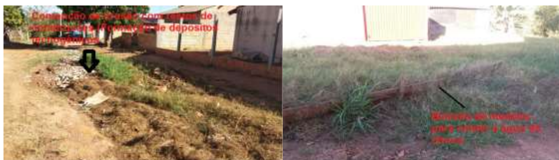
Figura 9 - Utilização de restos de construção para tentar conter processo erosivo nos bairros Jardim Carlos Gomes Bezerra I e II.
