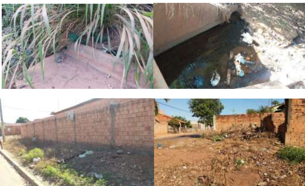
Figura 8 - Deposição de resíduos sólidos em córregos canalizados nos bairros Jardim Carlos Gomes Bezerra I e II.
