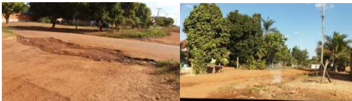
Figura 7 - Sulcos erosivos formados em ruas dos bairros Jardim Carlos Gomes Bezerra I e II.
