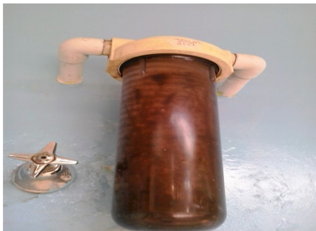
Figura 2 - Filtro de bebedouro sem manutenção.
