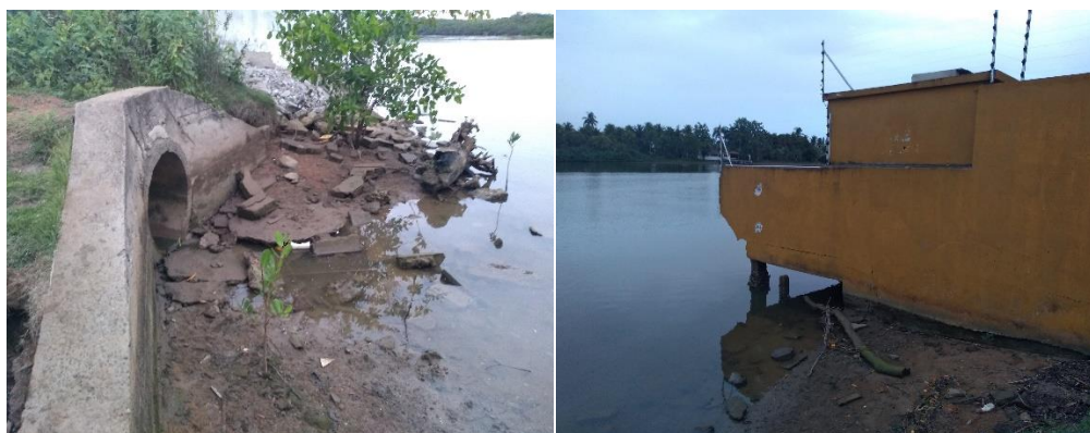
Figura 10 - Fotos do segmento D. À esquerda, lançamento de esgotos no Rio; à direita, casa construída praticamente sobre o Rio Reis Magos.
