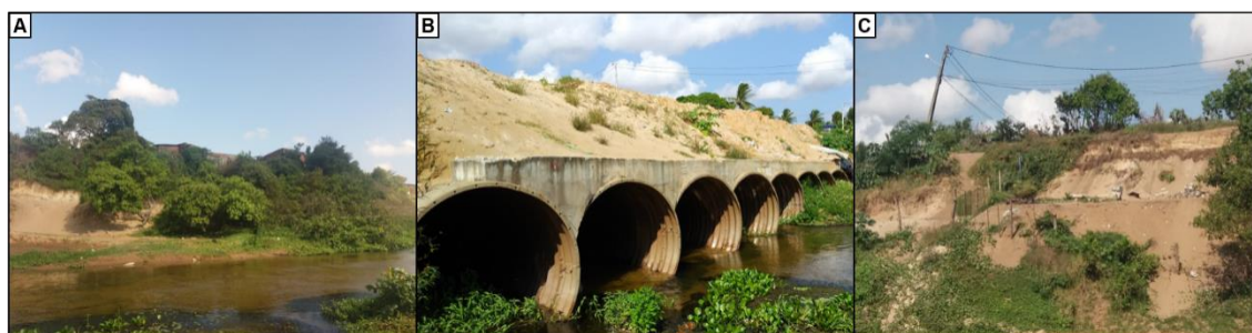
Figura 13 - Ocupação por residências no topo (interflúvio) da encosta do Rio Doce (A); Canaletas de vazão em rodovia sob Rio Doce (B); Desnudação de encosta e assoreamento do Rio Doce (C).
