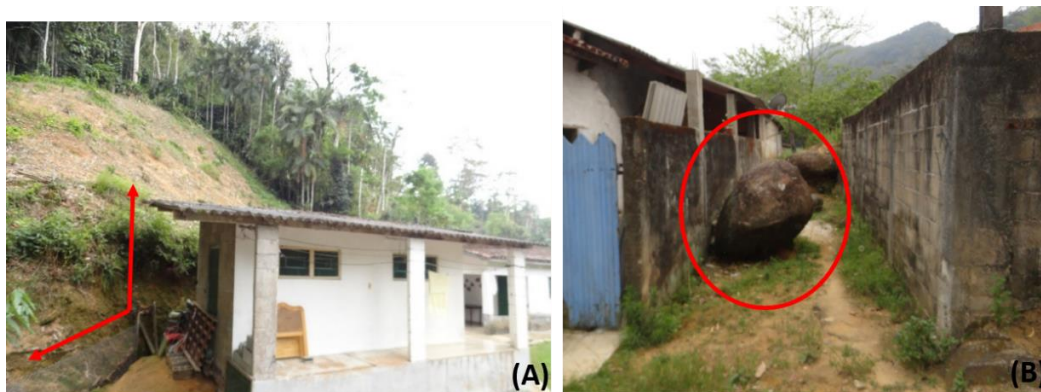
Figura 3: Habitação localizada ao sopé de encosta (A); blocos rochosos arredondados depositados próximo às casas (B)
