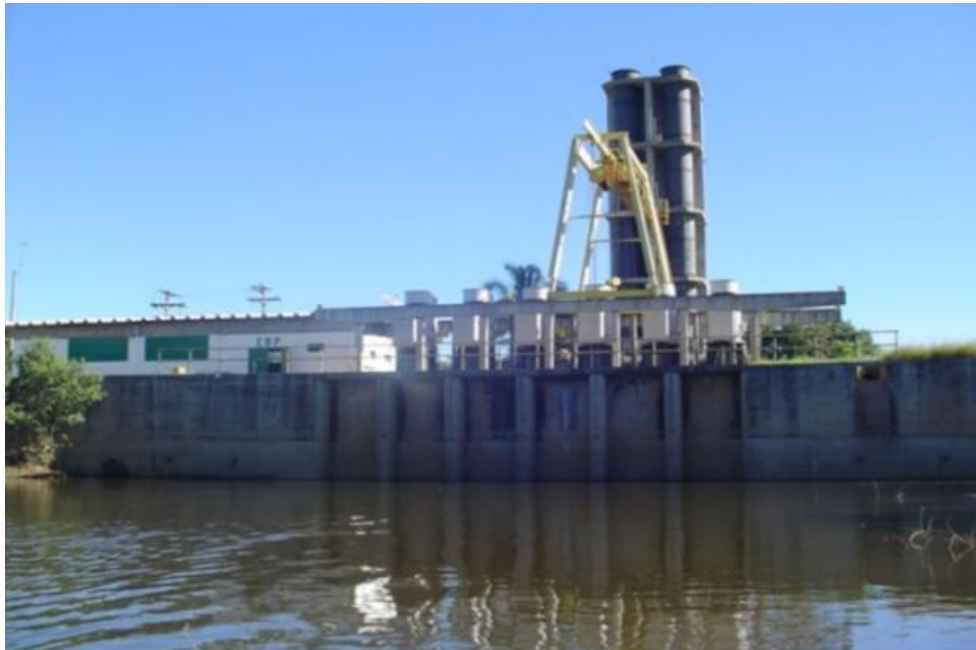
Figura 3. Principal estação de bombeamento no Perímetro de Irrigação Formoso
