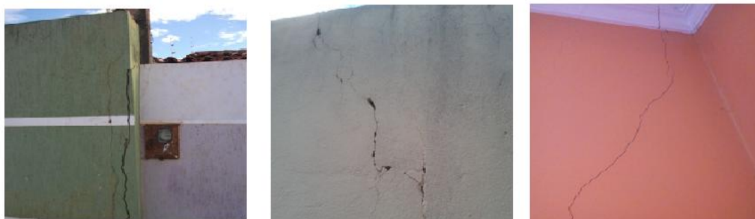
Figura 6. Trincas em muros e residências na unidade retilíneo-planar.
