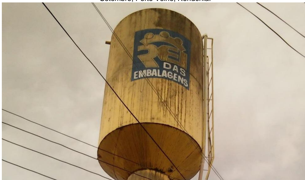
Figura 6. Material Particulado impregnado em caixa d'água, localizada na Rua Brasília com Sete de Setembro, Porto Velho, Rondônia.
