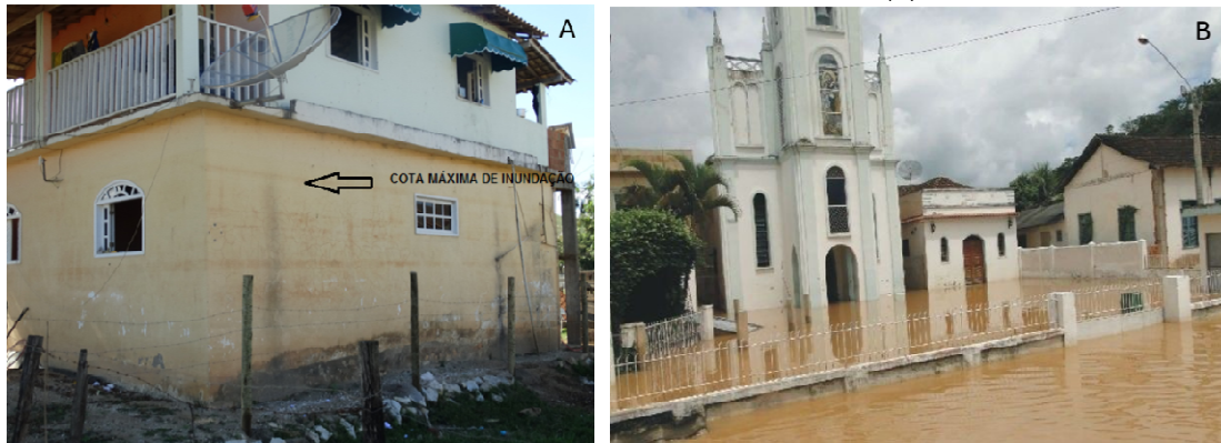
Figura 2. Marcas da enchente ocorrida em Cardoso Moreira em Janeiro de 2008 (A). Inundação da Igreja Matriz em Cardoso Moreira, Janeiro de 2012 (B).
