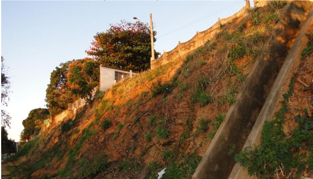
Figura 4. Talude da Avenida Sidney Chaves. No primeiro plano destacam-se os afloramentos de Siltitos. Ao fundo observam-se as primeiras casas que foram construídas ao longo do barranco.
