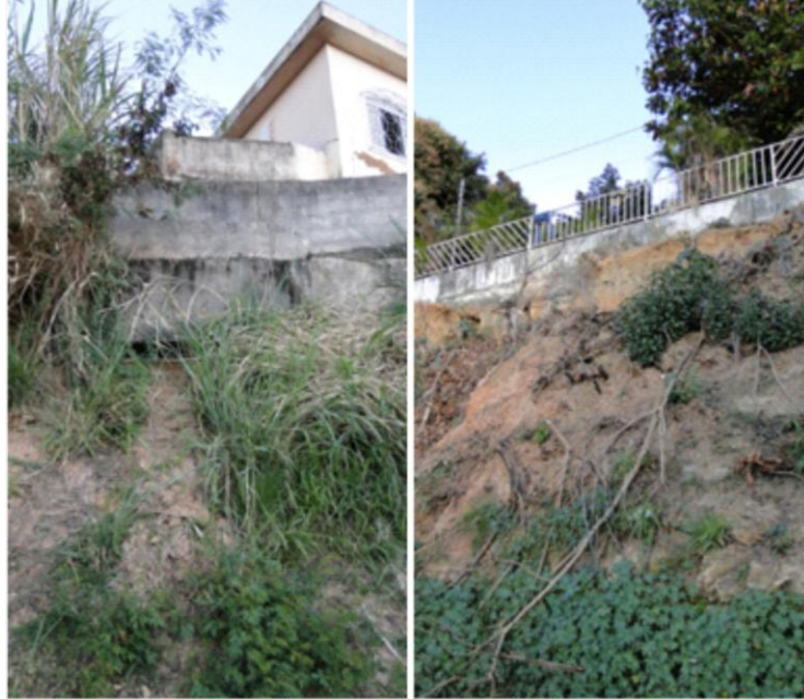
Figura 5. Horizontes superficiais do solo expostos com construção de muros de arrimo na área para evitar os deslizamentos.
