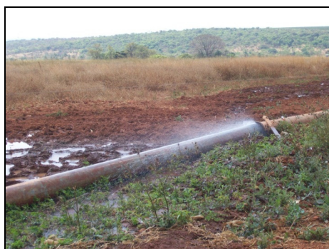
Figura 9: Vazamento em tubulação de água utilizada para irrigação de tomate - 2011
