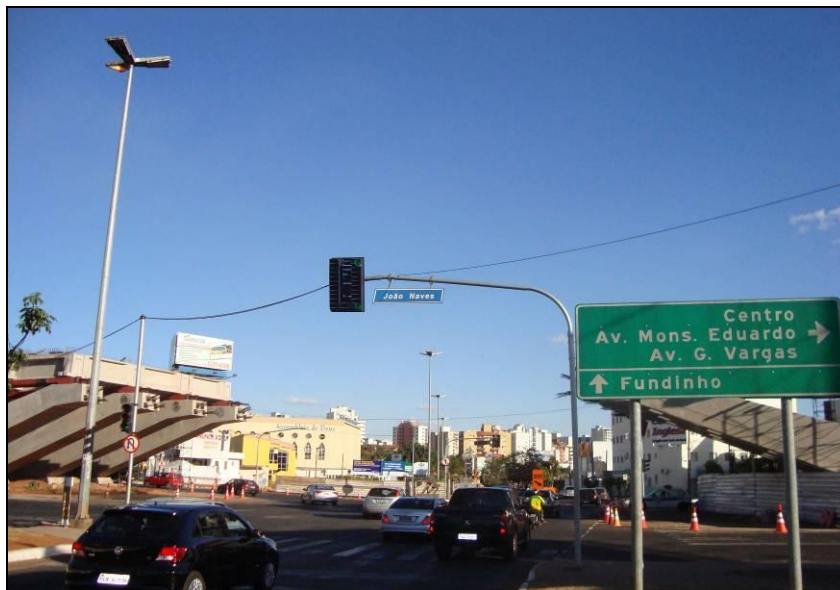
Figura 13 – Cidade de Uberlândia: construção do viaduto no cruzamento da Avenida João Naves de Ávila com a Avenida Rondon Pacheco em Uberlândia
