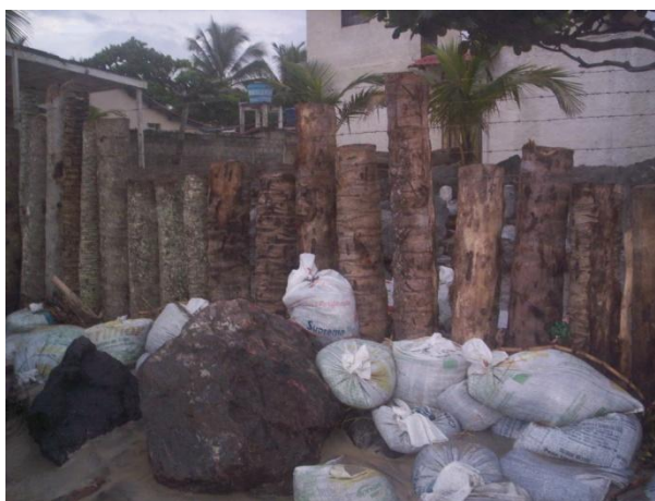
Figura 3: Estruturas de contenção de baixo custo, utilizando sacos de areia, troncos de coqueiro e blocos de rocha. Fonte: Dados da pesquisa.
