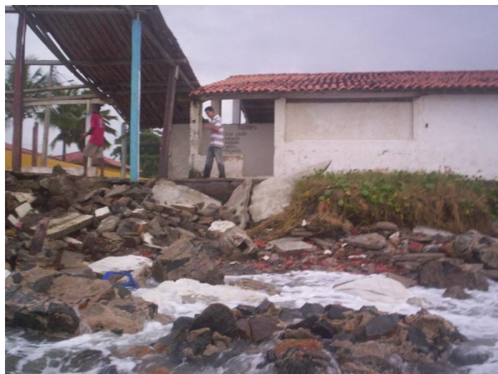
Figura 5: Escombros de construções destruídas e blocos de rocha deslocados pela ação das ondas. Fonte: Dados da pesquisa
