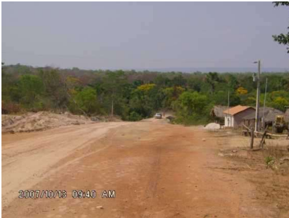
Figura 8 - Obras de adequação viária para encabeçamento de ponte sobre o Córrego Carrapato. Destaque para o uso inadequado da faixa de domínio com presença de moradias e pequenos estabelecimentos comerciais.
