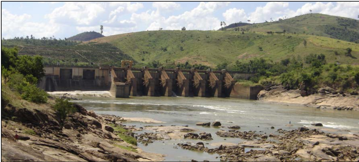
Figura 7 – Vista da barragem da UHE de Mascarenhas que iniciou sua operação em 1974. Foto do autor, Fev. 2006.
