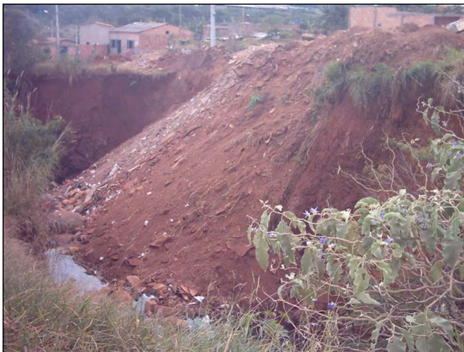
Figura 2 - Baixo curso do córrego Buritizinho. Detalhe para o desmoronamento da vertente em local onde foram depositados resíduos de construção civil para contenção da erosão
