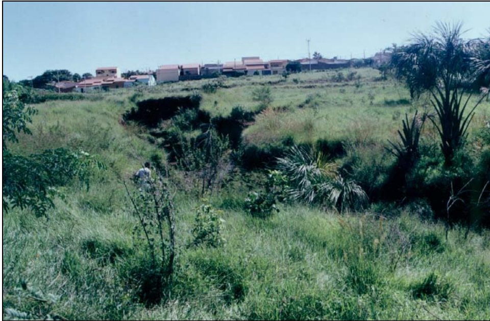
Figura 1 - Voçorocamento em uma das nascentes do córrego Bom Olhos em direção a cidade Jardim
