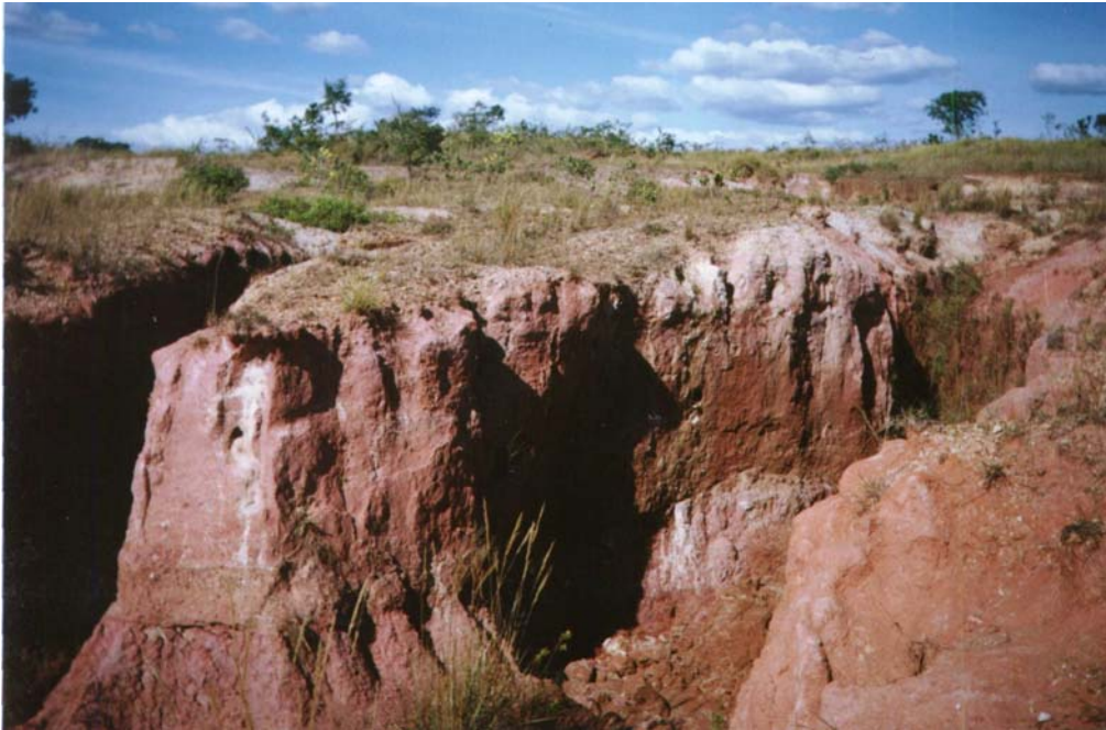
Figura 10 - Voçoroca instalada em área de empréstimo de material para a construção de barragem
