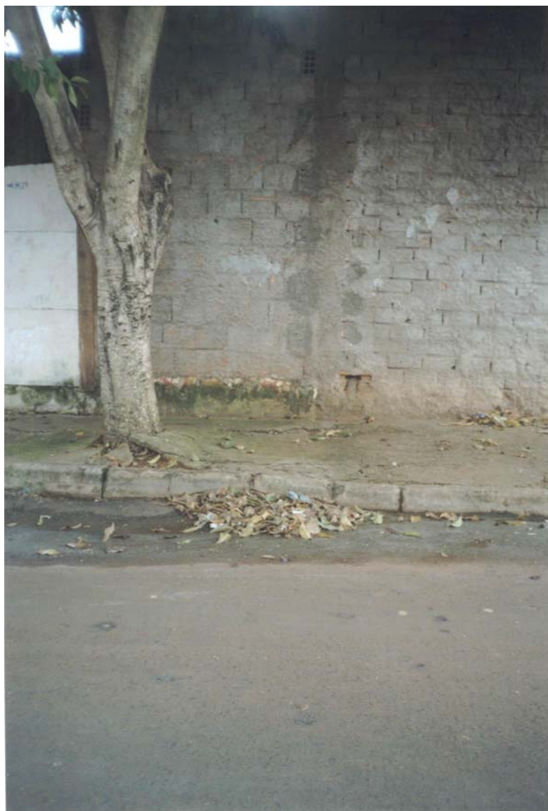
Figura 4 - Conflito com o passeio, raiz da árvores destruindo a calçada
