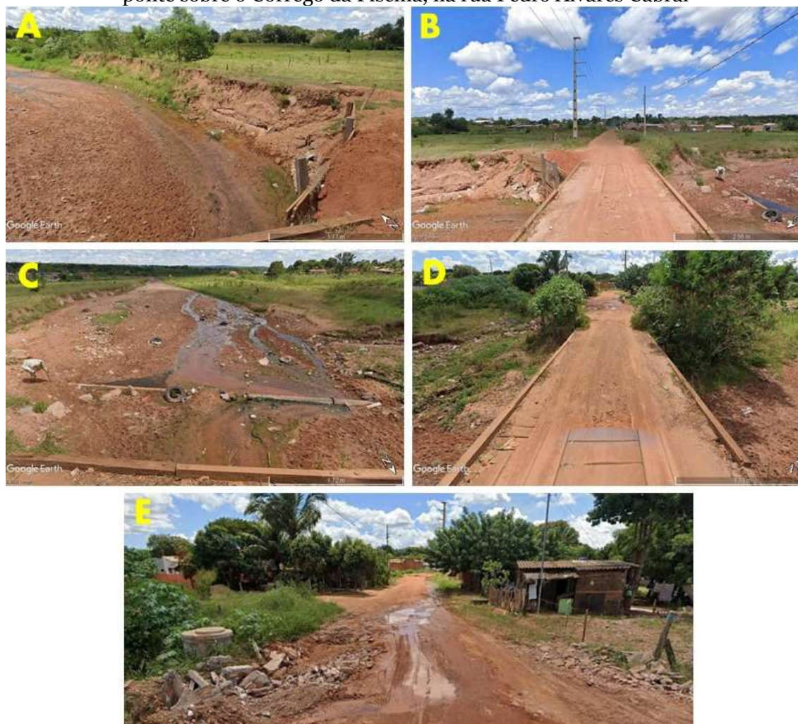
Figura 20 – Imagens obtidas pelo Google Earth Pro (Street View), de março de 2020, na ponte sobre o Córrego da Piscina, na rua Pedro Álvares Cabral
