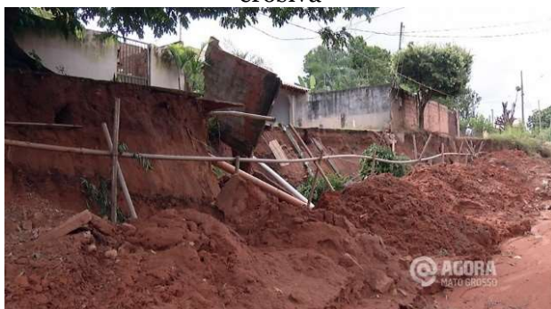
Figura 16: Fotografia de rua, no Jardim das Paineiras, assolada pelo avanço da feição erosiva
