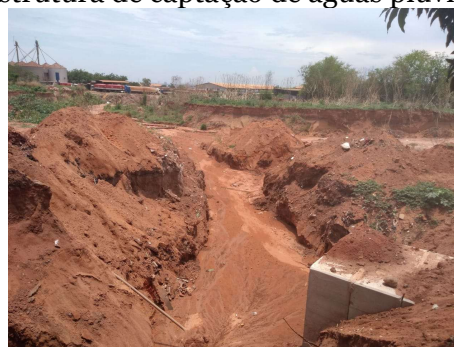
Figura 17: Vista parcial da feição erosiva, em novembro de 2019, e da estrutura de captação de águas pluviais
