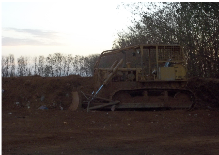
Figura 6: Máquina utilizada para fazer as valas no solo para deposição dos resíduos Autor: LUIZ, L. M., agosto/2011
