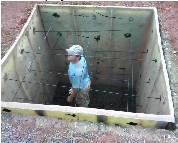
Figura 4. Detalhe da instalação das barras roscadas de ¼ de polegadas nas paredes do lisímetro 3. Uberlândia, 25 de abril de 2013.
