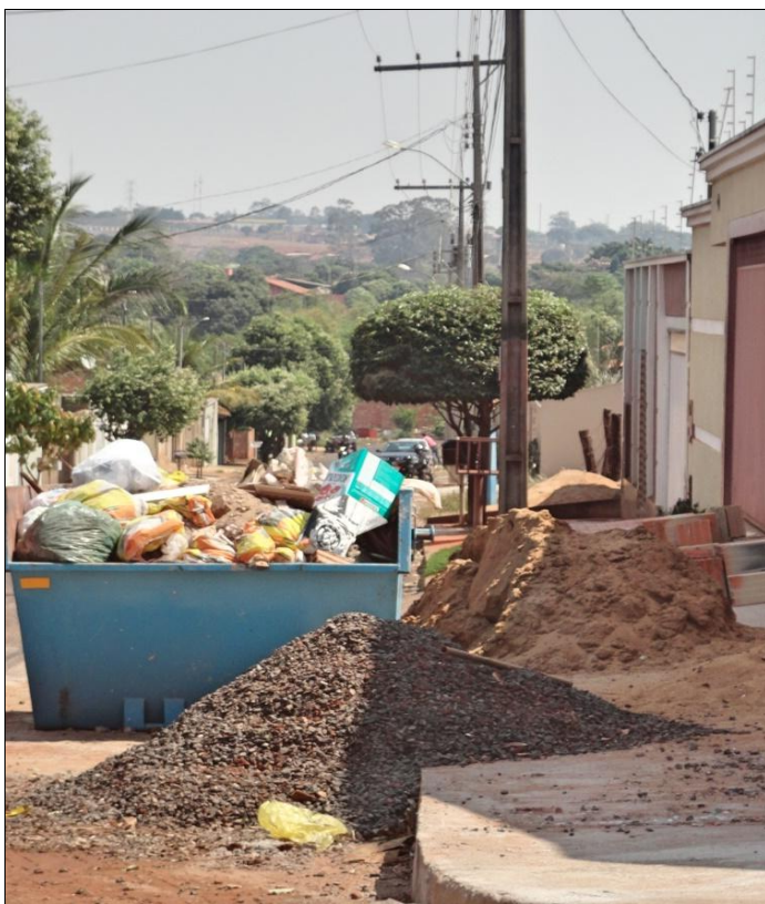
Figura 8 – Entulhos e materiais agregados em calçadas de obras particulares em Frutal-MG (2014).
