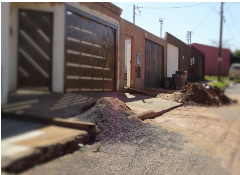
Figura 6 – Entulhos e materiais agregados em calçadas de obras particulares em Frutal-MG (2014).
