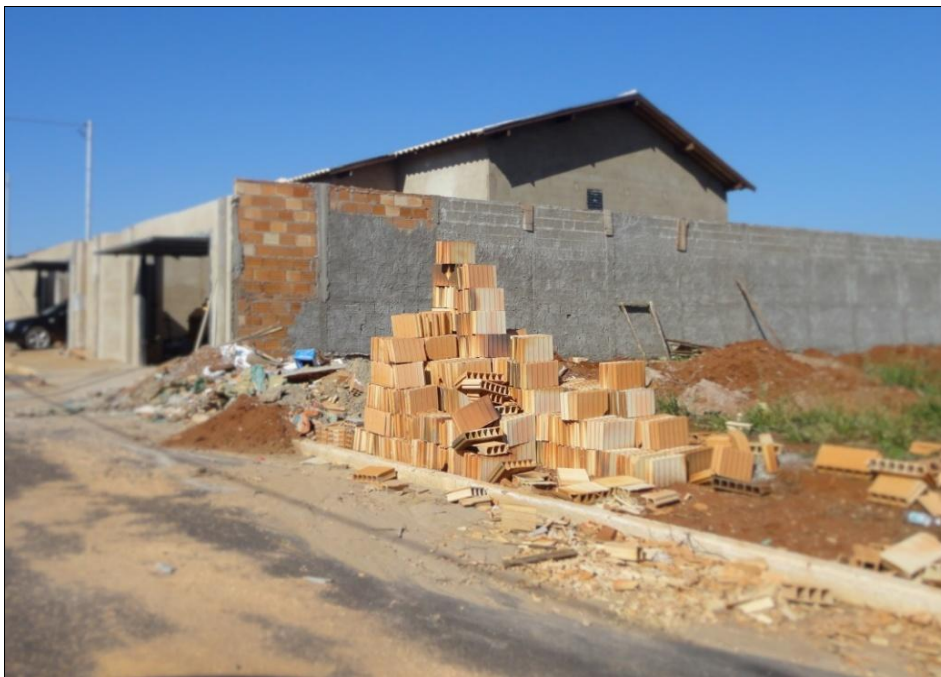
Figura 7 – Entulhos e materiais agregados nas sarjetas em Frutal-MG (2014).
