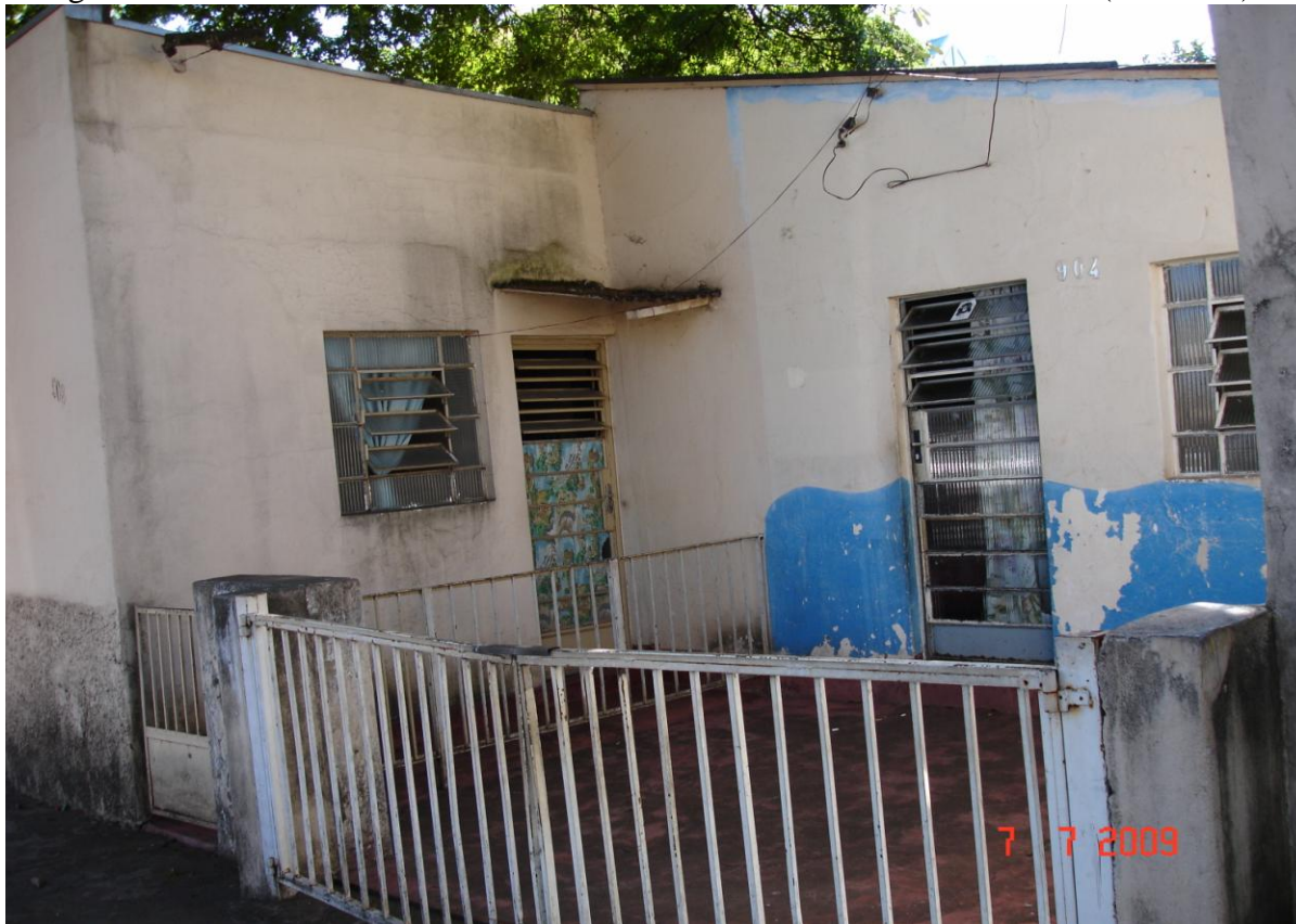
Fotografia 1: Residência deteriorada localizada na Av. Raulino Cotta Pacheco (B.Martins).
