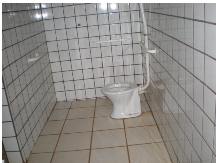
Figura 07: Parque do Sabiá, Banheiro adaptado mas sem porta para cadeirantes, 2009 Autor: SILVA, E. M. ago/2009
