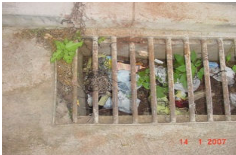
Figura 1 – Bueiro entupido com lixo. Foto: João Fernando Dias.
