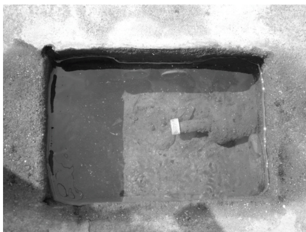
Figura 3 - Caixa de inspeção presente na residência da propriedade onde está a nascente do Bebedouro.
