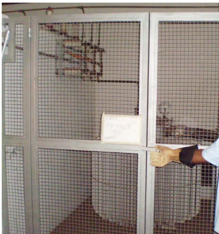
Figura 9 – Transformador n.º 3 de 500 kVA – 13,8 / 0,38 – 0,22 kV, responsável pela entrega de energia no setor dos equipamentos eletromédicos analisados.
